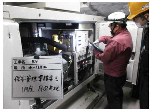
水口頭首工電気保安管理業務委託
